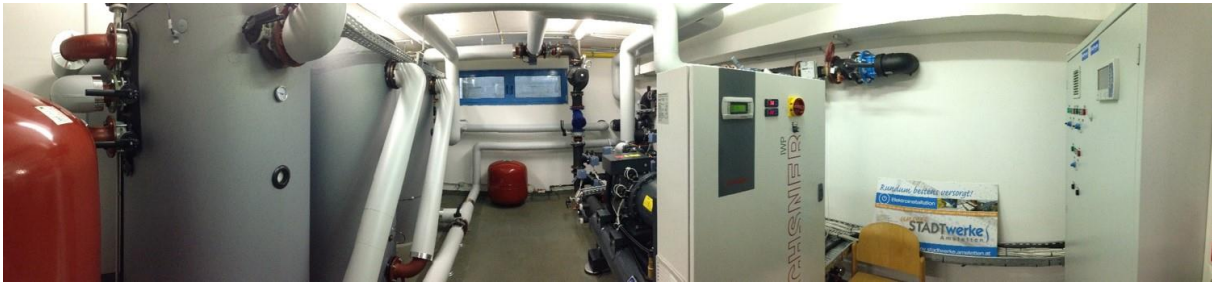
Abbildung 8: Stadtwerke Amstetten als Beispiel einer realisierten Anlage zur Energiegewinnung aus Abwasser, Quelle: Ochsner
