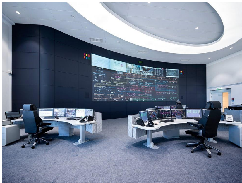
Abbildung 5: Netzleitwarte der Wiener Netze GmbH (Quelle: Wiener Netz GmbH)
