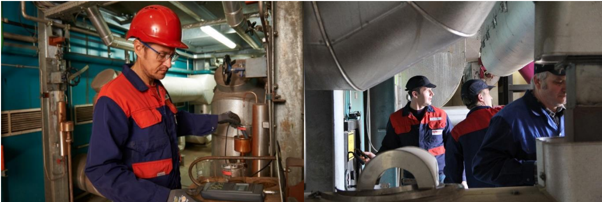
Abbildung 19: Anlagentechniker führen Wartungs- und Instandhaltungsarbeiten durch (Quelle: NAWARO ENERGIE)
